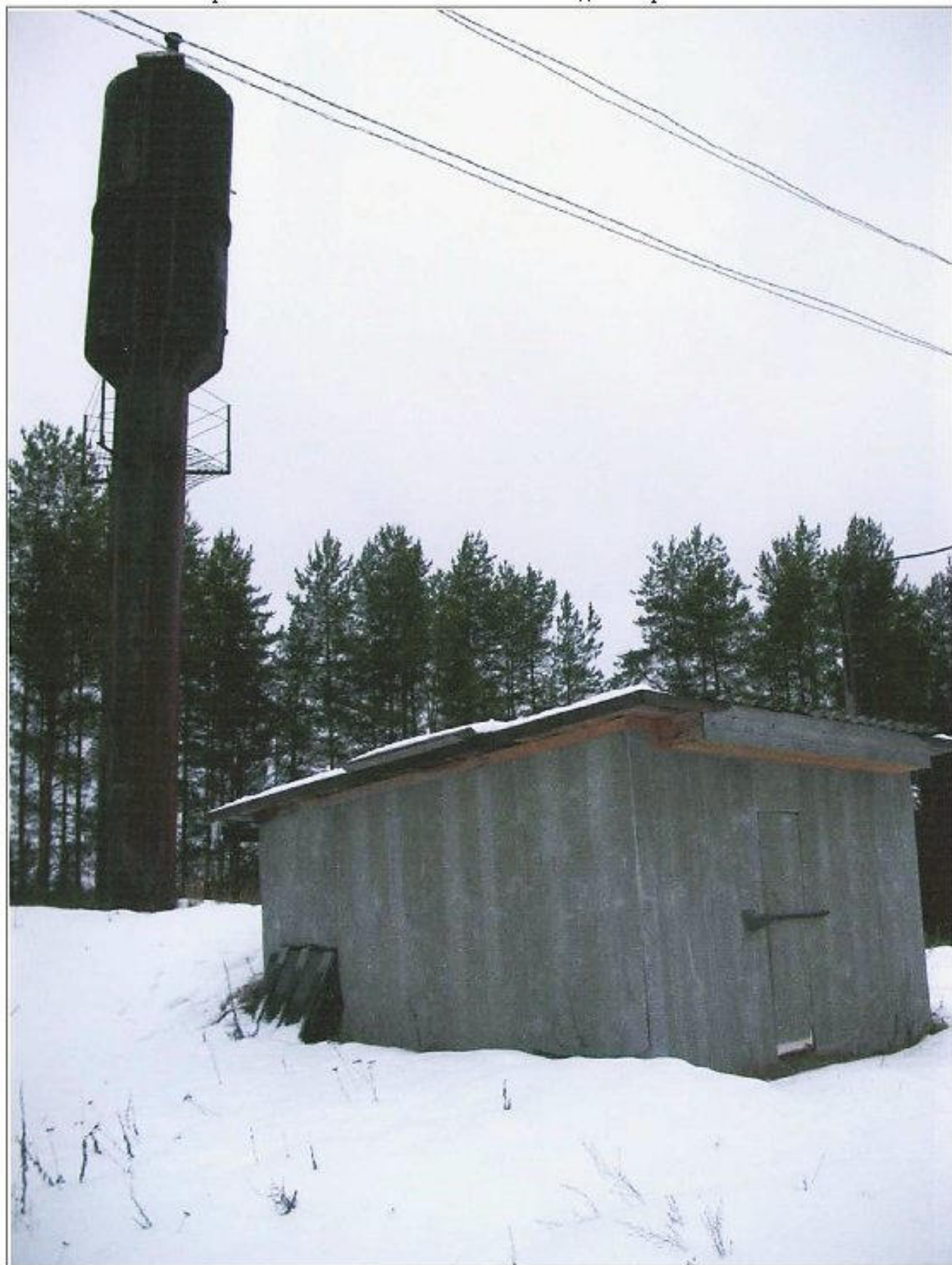
Артезианская скважина №14318 и водонапорная башня
